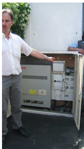
Régulateur de tension de 1 ère génération en fonctionnement dans un poste EP de St-Jean de Braye
