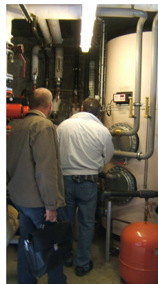
Stockage de l'eau chaude sanitaire
