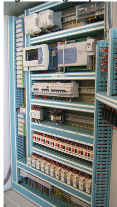
Armoire de régulation de la chaudière du CTM
