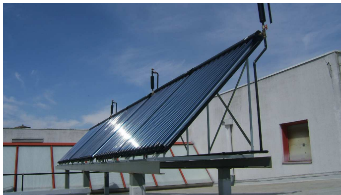
Installation solaire en toiture : panneaux solaires thermiques sous vide
