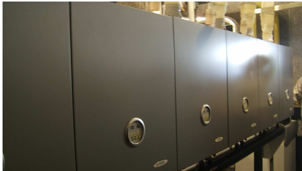
Chaudières à condensation en cascade pour le chauffage d'un groupe scolaire
