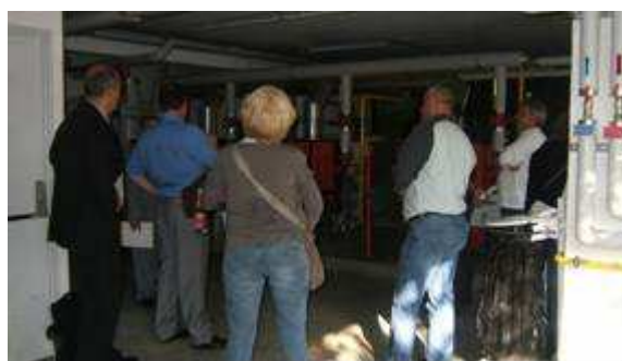
Chaufferie de la maison de retraite
