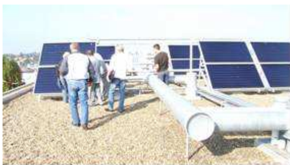
100 m 2 de capteurs solaires thermique en terrasse
