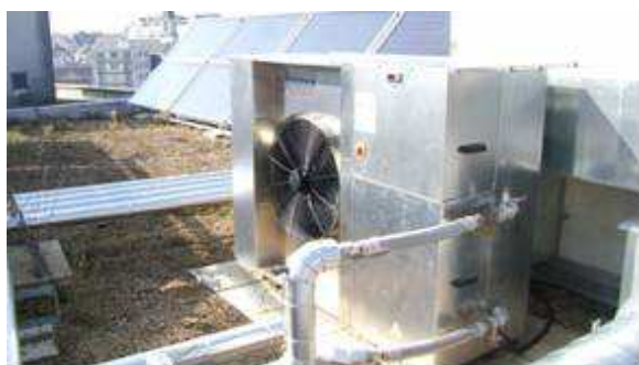
Pompe à chaleur sur l'air extrait de la VMC
