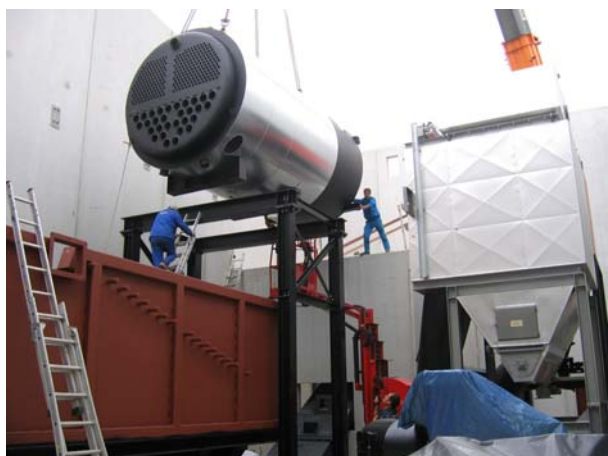
Chaudière bois à Blois
